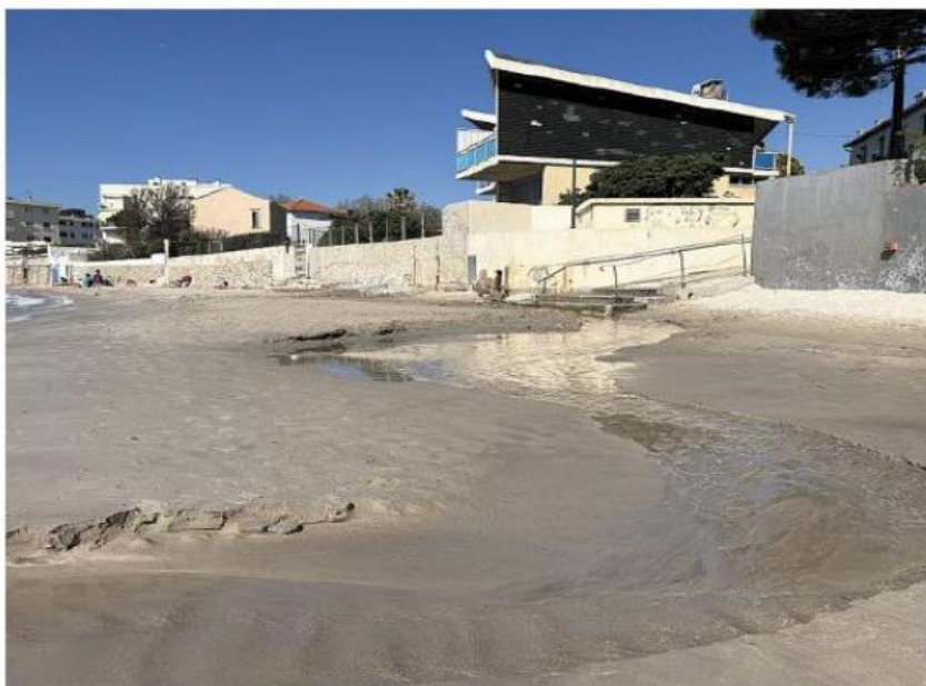
C'est en contrebas de la station de relevage située au milieu du linéaire de la plage que l'écoulement est le plus impressionnant, tel un petit ruisseau qui rejoint la mer emportant avec lui une partie du sable. PHOTO M. G.
